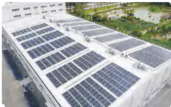
李锦记新一生产基地太阳能光伏项目
